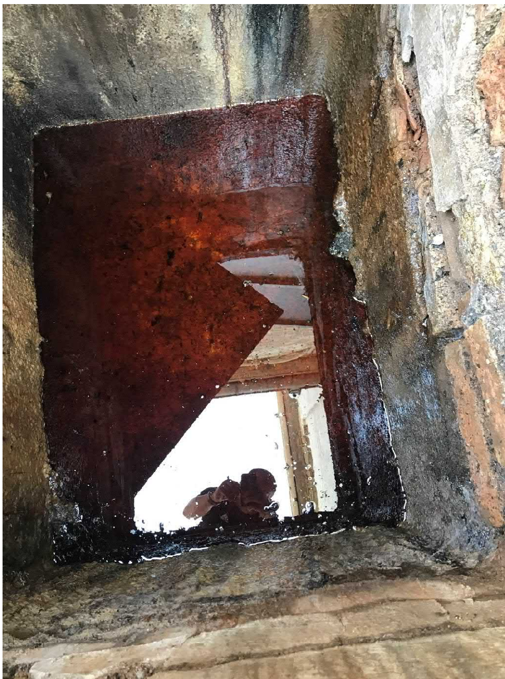
Bild 10: KVF 16, Schacht vor Transformatorenkammer
