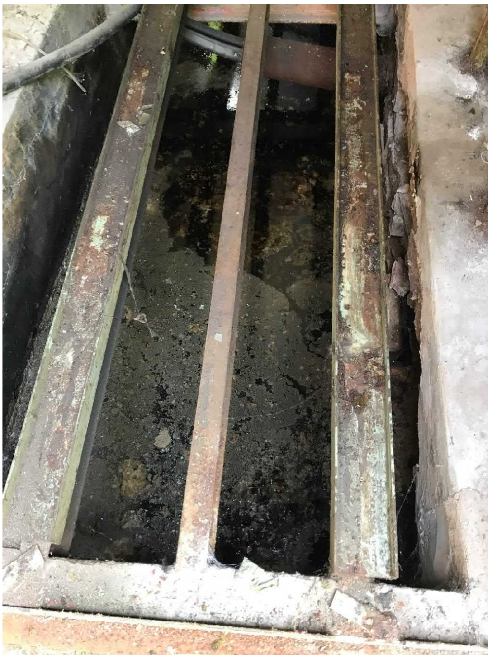
Bild 9: KVF 16, Auffangwanne nach Transformatorausbau
