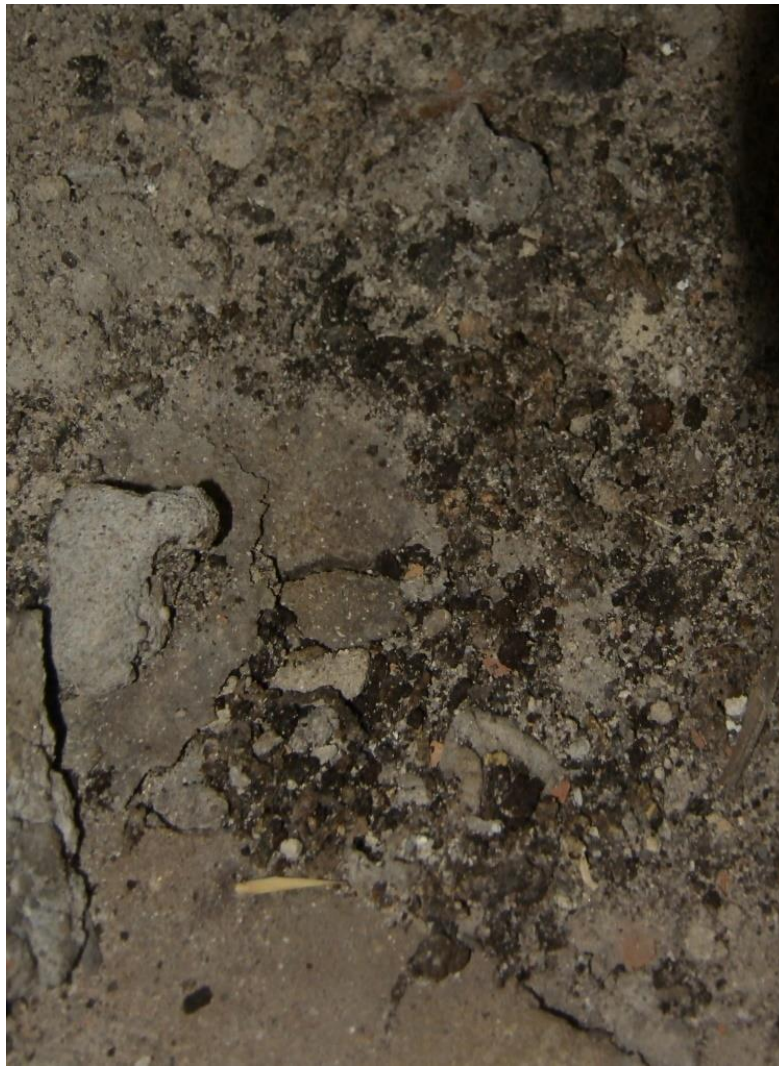
Abbildung 34: Fledermauskot auf dem Dachboden des Wohnhauses.
