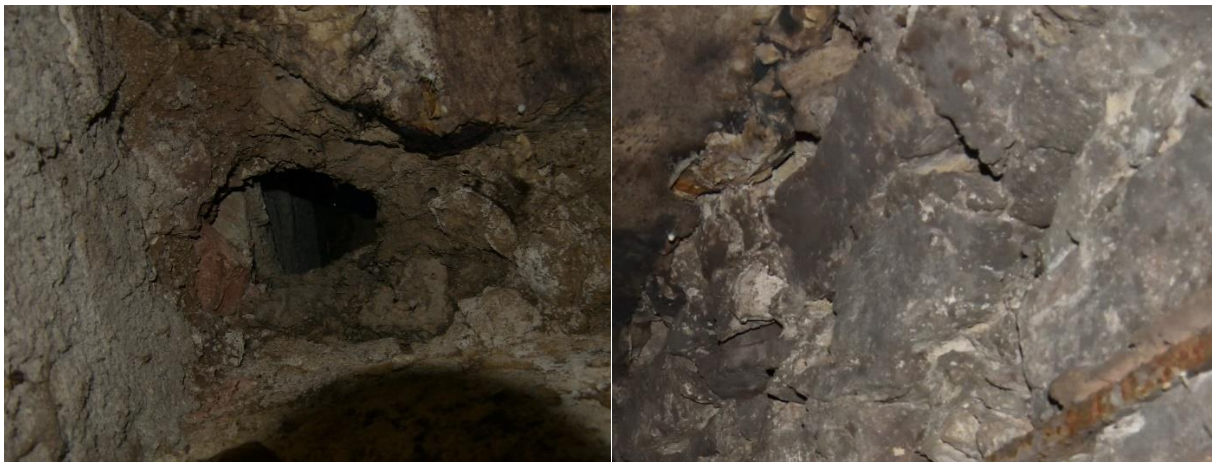
Abbildung 40: unverputzte Natursteinmauer im hinteren Teil des Kellers, in dem Weinfässer gelagert werden. Potentielle Quartiere für Fledermäuse.
