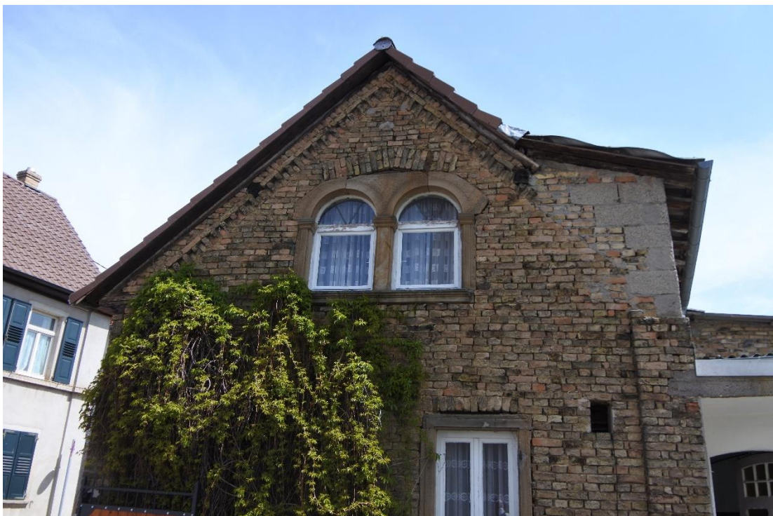
Abbildung 27: Dichte Fassadenbegrünung, hier am Gebäude Rheinstraße 11A, bietet ebenfalls Habitate für Gebüschbrüter und Säugetiere an (Fotos: BGNatur).
